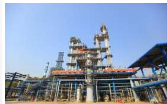
Установка извлечения легких углеводородов
