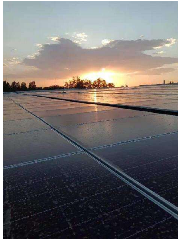
Фотоэлектрическая установка на крыше New Dadong мощностью 1,6 МВт.
